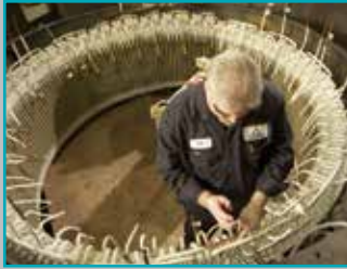
PowerSeal™ VPI Rewind
