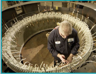
PowerSeal™ VPI Rewind
